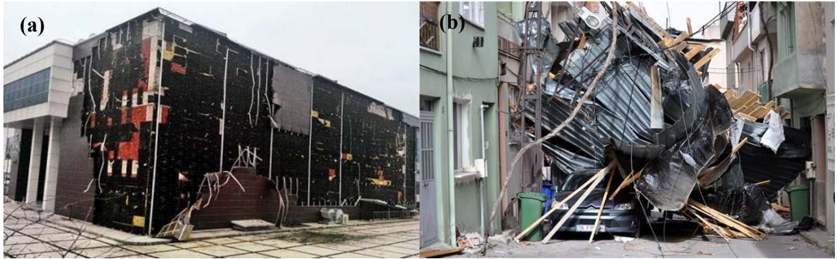
Şekil 1. Bursa’da lodos sonrası (a) Afet Eğitim Merkezi Binasının görünümü [1] (b) bir sokak görünümü [2]
