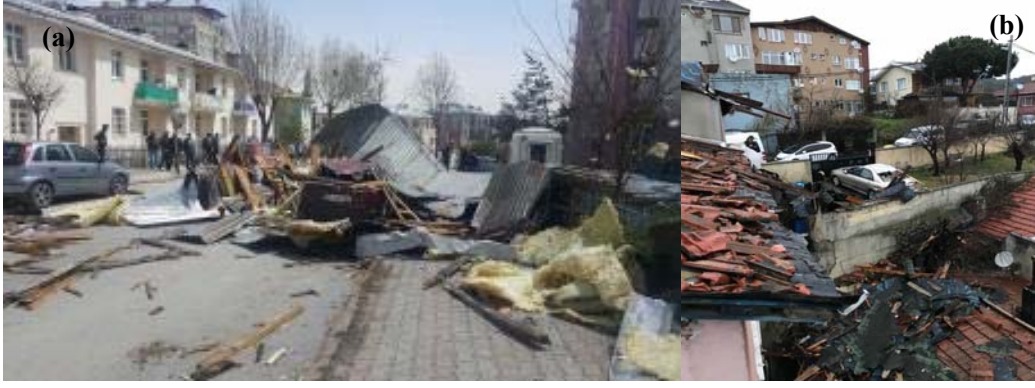
Şekil 3. (a) Sivas’ta rüzgardan uçan çatılar [5] (b) İstanbul’da rüzgardan uçan çatılar [6]
